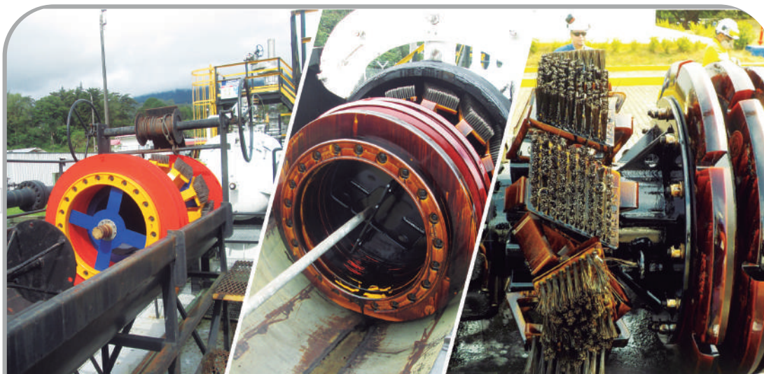
Limpieza con altos niveles de Pitting
